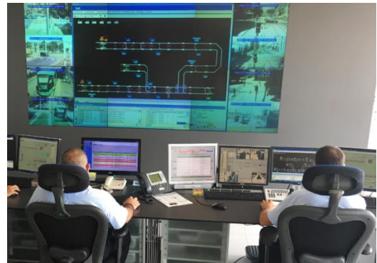
Sala de Control
