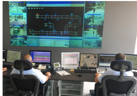
Sala de Control
